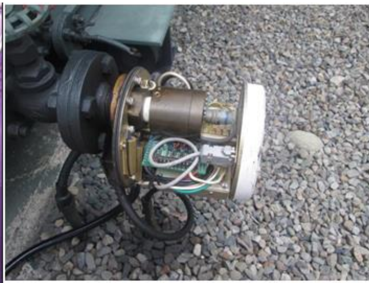
說明：#1 ATRR 相 TCG 電源線、訊號線配置
