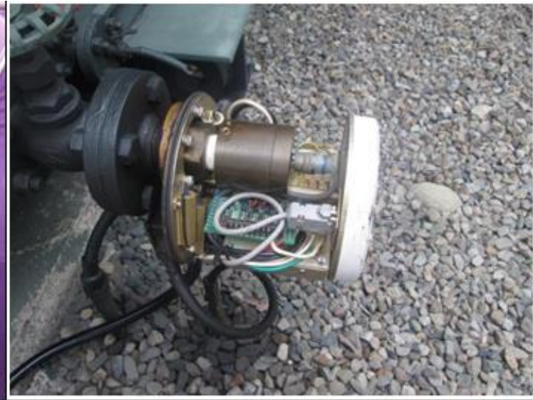
說明：#1 ATRR 相 TCG 電源線、訊號線配置
