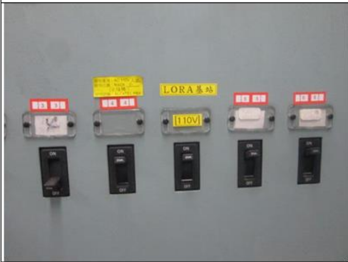
說明： LoRa 基站電源開關 ↻
