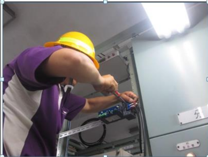
說明： LoRa 基站安裝 ↻
