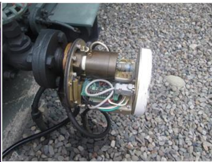
說明：#1 ATRR 相 TCG 電源線、訊號線配置
